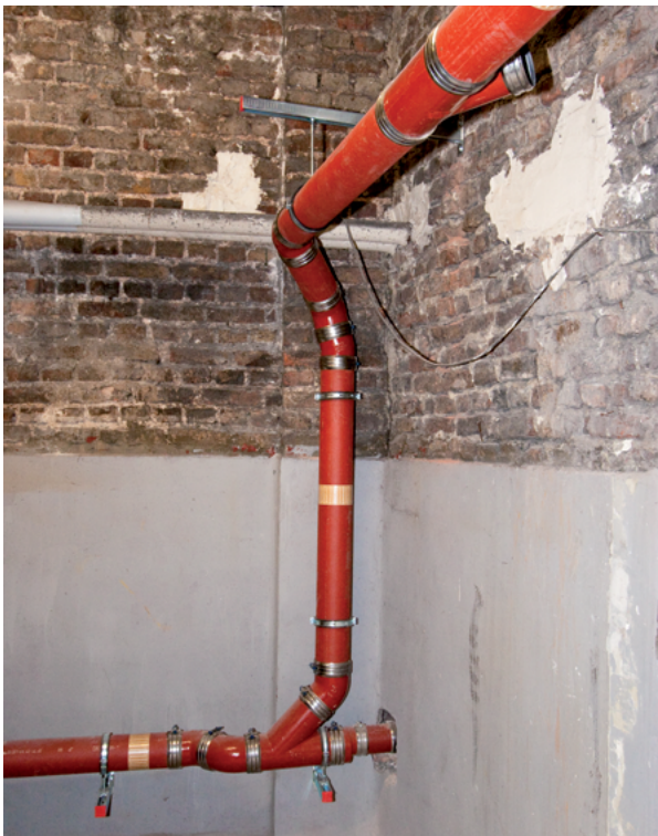
Abgehängte Leitungen an der Kellerwand
