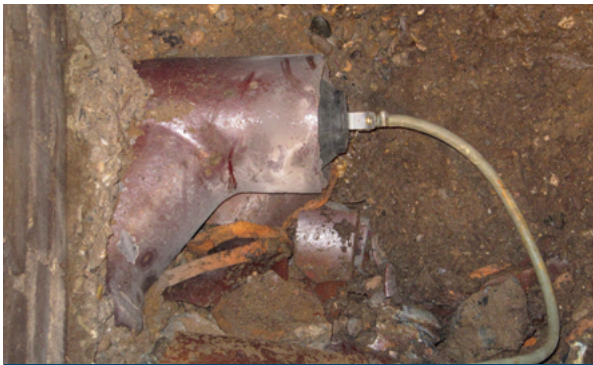
Absperrblase zur Dichtheitsprüfung
