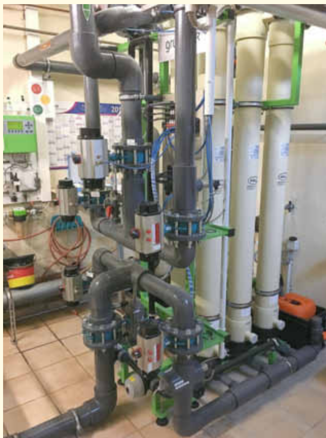
Neue Filteranlage Schulschwimmbad
