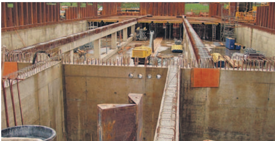
Ein Blick der Gäste in das Bauwerk zeigt die Außen-, Leit- und Trennwände sowie die Stützen, auf die in Kürze die Schalung für die Deckenkonstruktion kommt.
